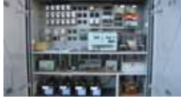
踏切制御装置
