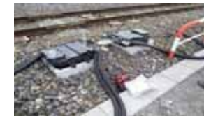
軌道回路設備
