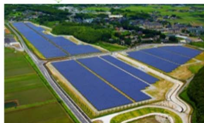
吉野ヶ里カ「リ」ラ-発電所
